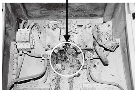
図1 バスバー付近の焼損状況
